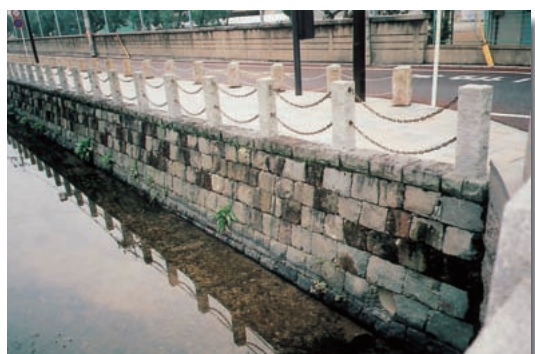
▲改修された石垣護岸。一部に「赤石」が使われている (県庁南側)
