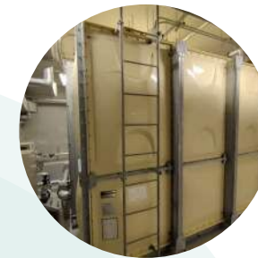
設備の老朽化
