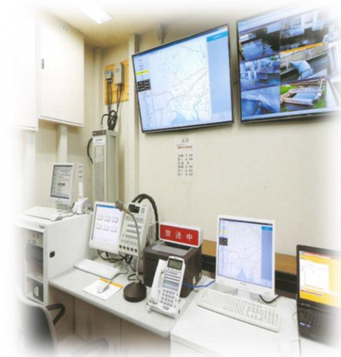
◆親局設備（市庁舎）
