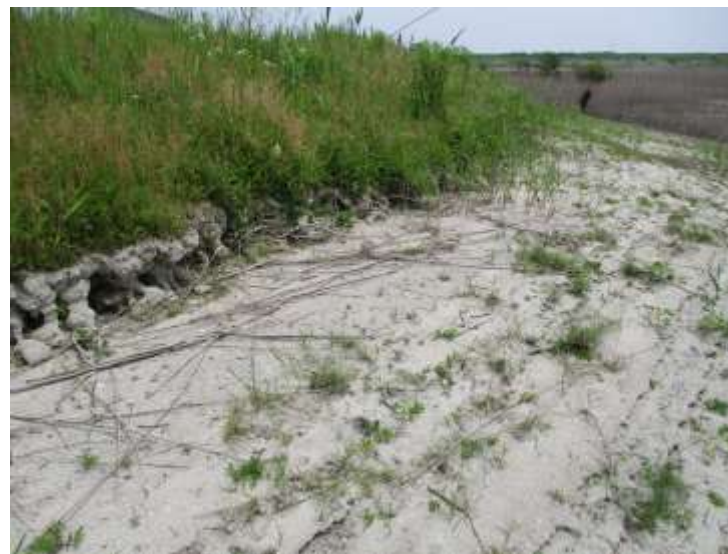
第3貝塚南側法面(水際浸食状況)
