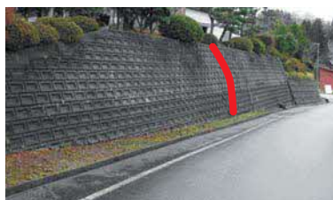
擁壁下端のハラミ出し
