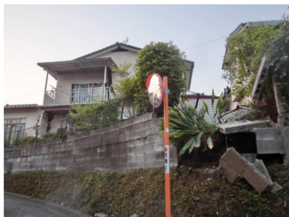
図 ブロック塀倒壊
