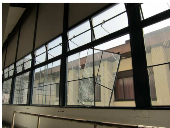
図 窓ガラスの損傷
