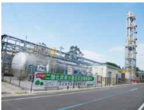
▲二酸化炭素分離回収設備
