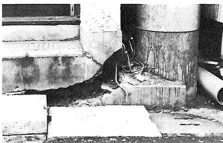
これが地盤沈下！（大財一丁目）
