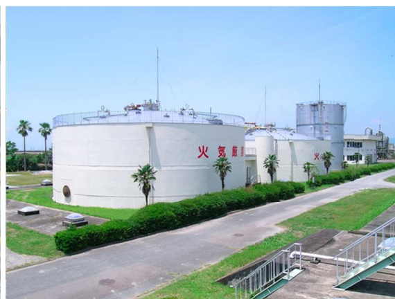
消化ガスを発生させる消化槽
