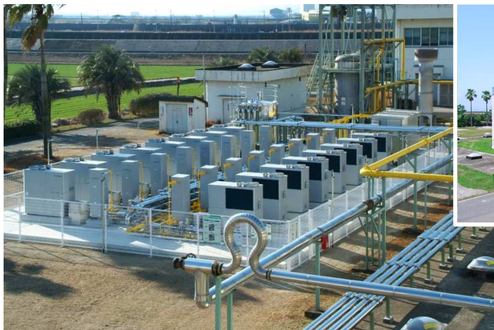
現在稼働中の消化ガス発電設備（25 kW×16台＝400 kW）
