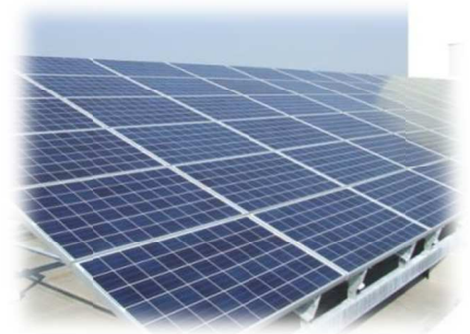
[写真] 本庁舎の太陽光発電システム
