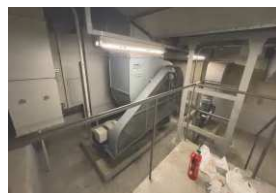
換気が十分に機能していない
