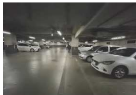
駐車場内の照明が暗い
