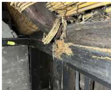
【小屋組みの損傷】
