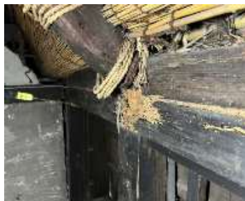
【小屋組みの損傷】
