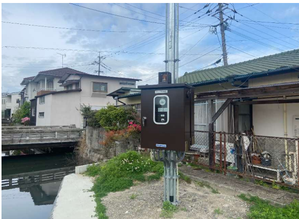
【① 水質浄化施設】
