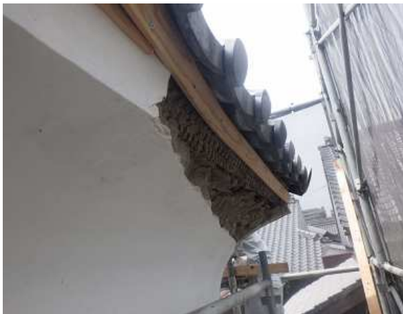
【損傷状況(軒下)】
