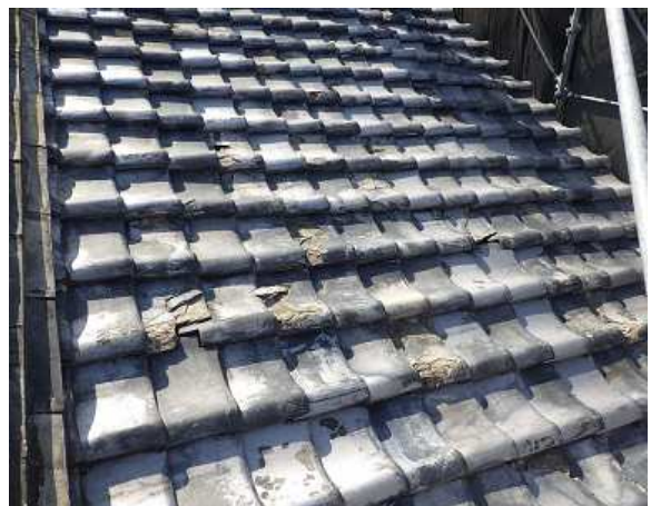
【損傷状況(屋根瓦)】
