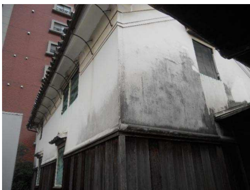
【損傷状況(外壁の老朽化)】
