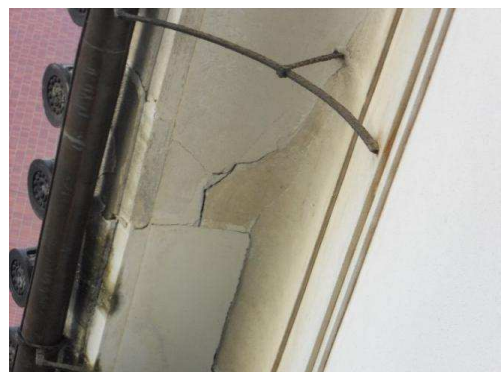
【損傷状況(漆喰落ち)】
