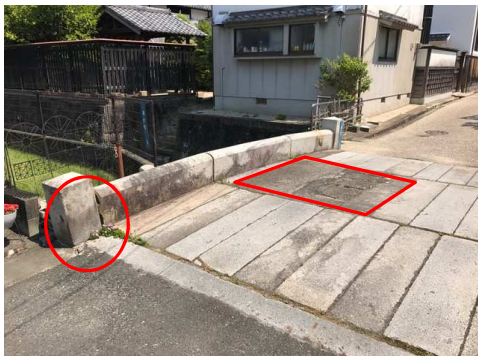
親柱の傾き、 一部コンクリート補修された石橋 (古賀善橋)
