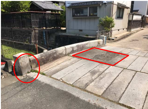
親柱の傾き、 一部コンクリート補修された石橋 (古賀善橋)
