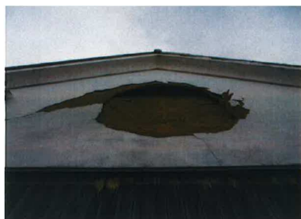
破損状況(東面の壁)
