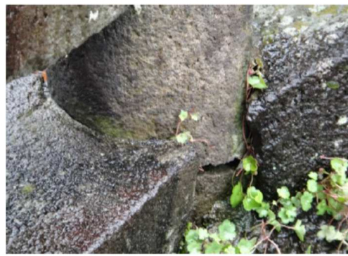
親柱の足元割れ
