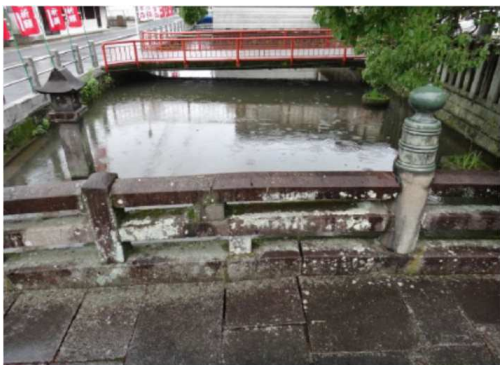
石橋の高欄破損状況
