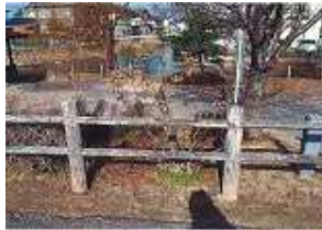
軽度の腐食のある防護柵
