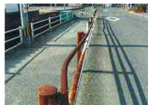
変形・腐食した防護柵
