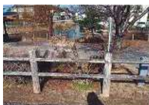
軽度の腐食のある防護柵
