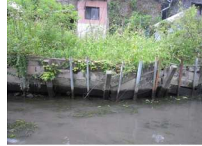
崩れかけている護岸
