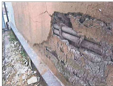
外壁 西面土壁剥落
