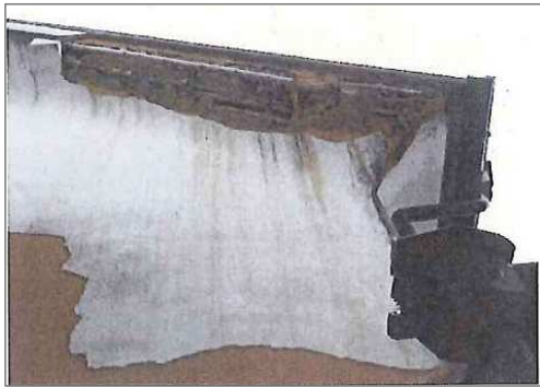
のどくり軒 西面土壁剥落
