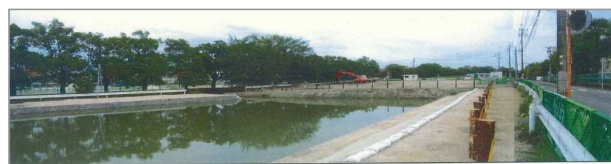
掘削され堀に復元された東堀の一部 〔北端から撮影〕 竣工
