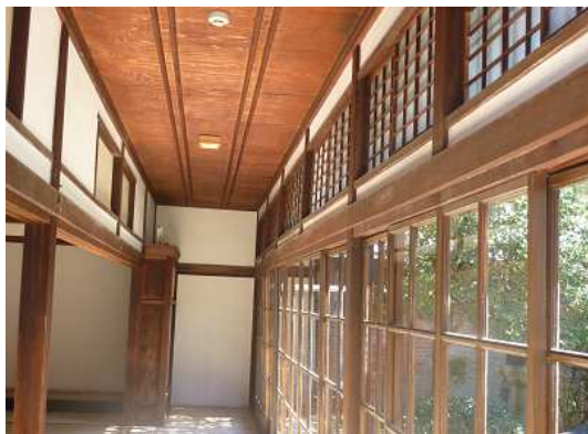
破損状況(柱の倒れ)
