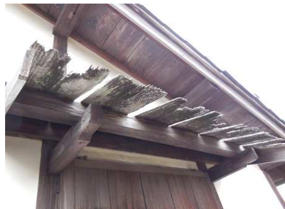
窓上木庇の雨腐れ
