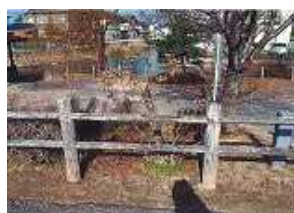
軽度の腐食のある防護柵
