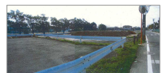
着工前 昭和13年・14年度に埋められた東堀 〔北西端から撮影〕
