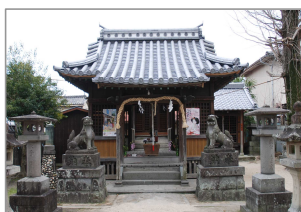
八坂神社の屋根の修復(竣工) 長崎街道・柳町景観形成地区
