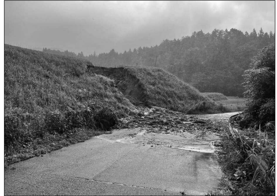
○農地・農業用施設災害 9月豪雨(三瀬村井手野地区)
