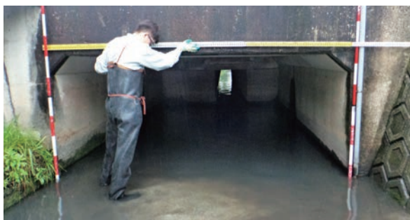
▲排水効率を悪くしている水路の狭窄部。県道下部分が狭くなっており、現在進められている改修工事で流下能力は約14倍に改善する（大財町）
