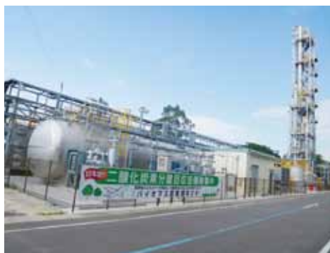
▲二酸化炭素分離回収設備
