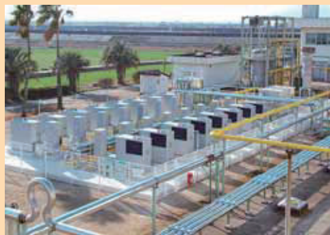
汚泥から発生する消化ガスによる発電 施設の電力の43%をまかっています。
