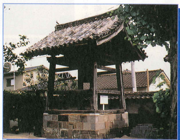
▲修理前の鐘楼
