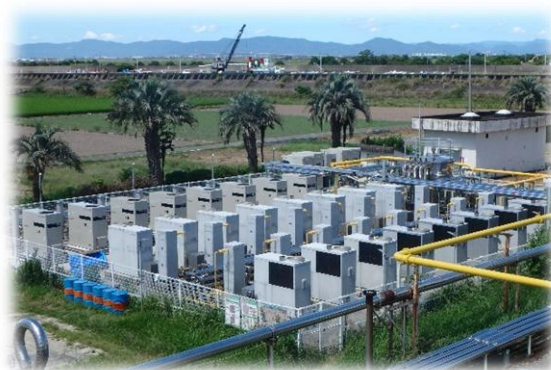
〔写真〕 下水浄化センターの 消化ガス発電システム
