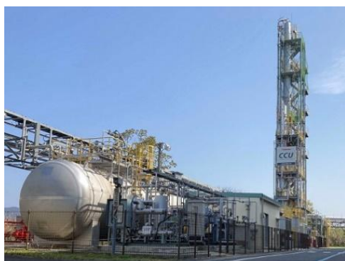
二酸化炭素分離回収設備
