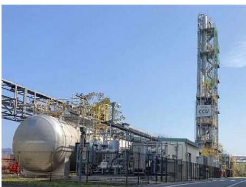
二酸化炭素分離回収設備
