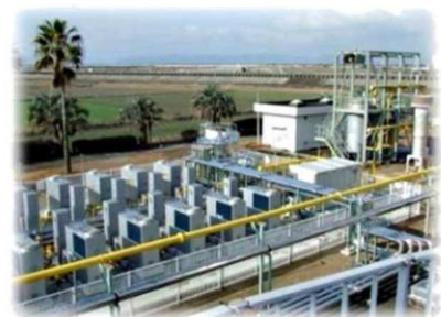
【写真】下水浄化センターの消化ガス発電システム
