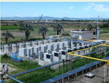
消化ガス発電システム
