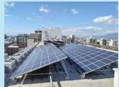
太陽光発電(市役所本庁舎)
