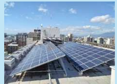
太陽光発電(市役所本庁舎)
