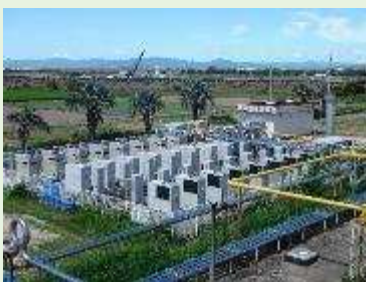
消化ガス発電システム
