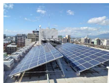
太陽光発電（市役所本庁舎）
