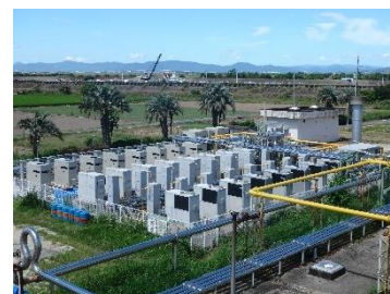
佐賀市下水浄化センターの消化ガス発電
