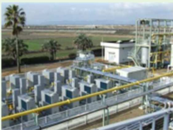
消化ガス発電システム
