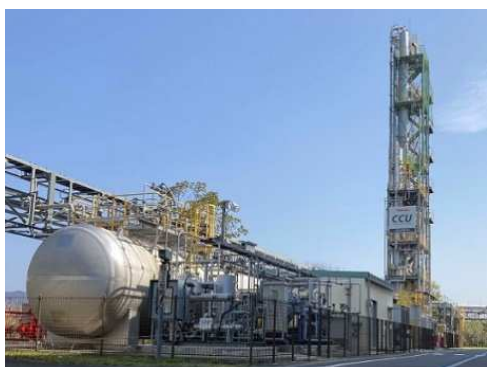
二酸化炭素分離回収設備
