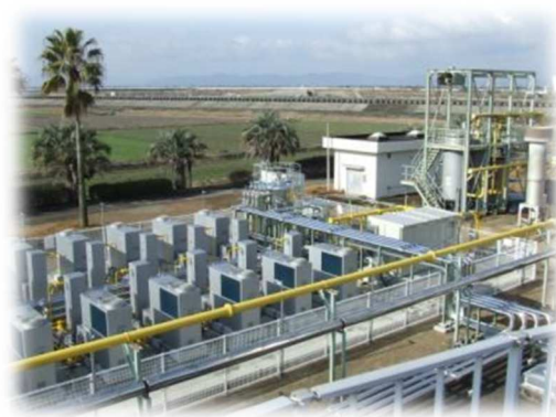
[写真] 下水浄化センターの 消化ガス発電システム
