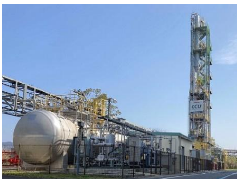
二酸化炭素分離回収設備
