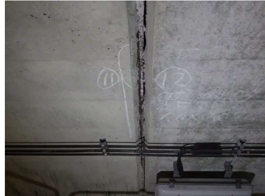
目地部の鉄筋露出・腐食 (けいのん森の花道)
