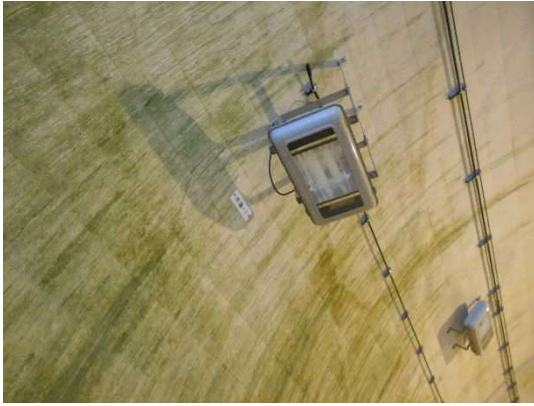
現況の照明施設 (けいのん森の花道)
