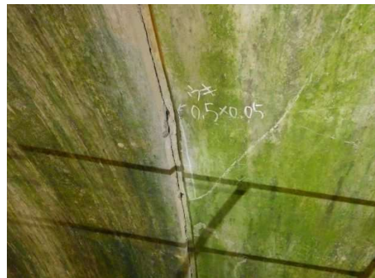
覆工コンクリート側壁部のうき (須田トンネル)
