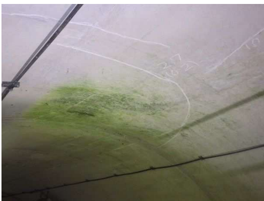
覆工コンクリート天端のひび割れ (畑瀬トンネル)
