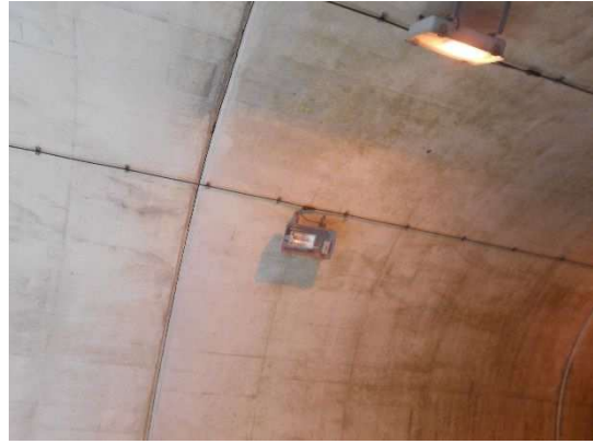
現況の照明施設 (畑瀬トンネル)
