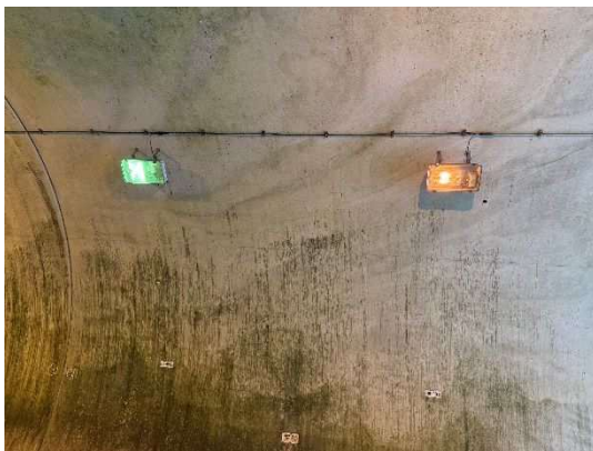
現況の照明施設 (須田トンネル)
