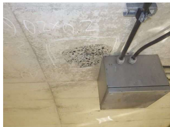
覆工コンクリートのはく離 (畑瀬トンネル)
