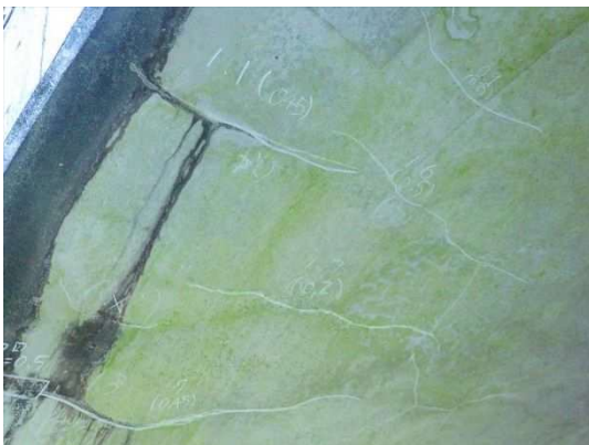
覆工コンクリートの天端のひび割れ (須田トンネル)
