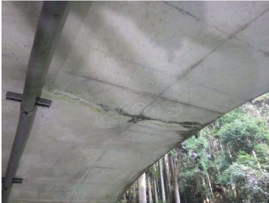
覆工コンクリートの天端のひび割れ (けいのん森の花道)
