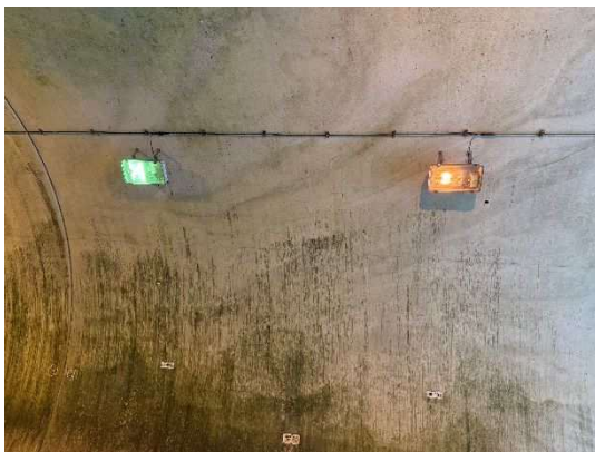
現況の照明施設 (須田トンネル)
