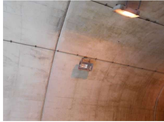
現況の照明施設 (畑瀬トンネル)
