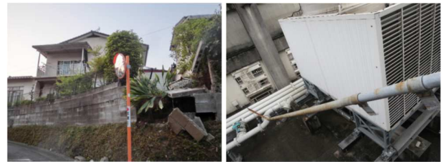
図 ブロック塀倒壊・避雷針の倒壊 出典：国土交通省国土技術政策総合研究所資料
