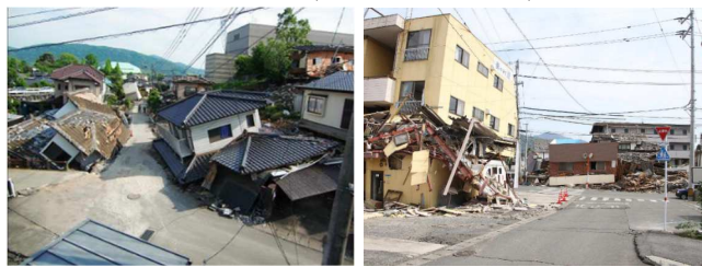
図 平成28年熊本地震による建築物の被害（熊本県益城町） 出典：熊本地震デジタルアーカイブ
