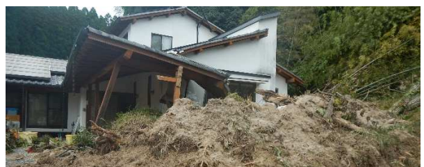
▲ 令和3年8月豪雨 佐賀市大和町名尾の建物被害
