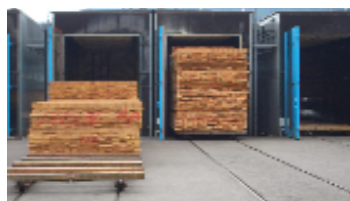
木材乾燥設備
