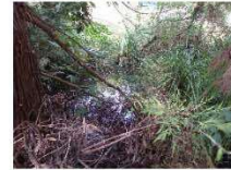
荒廃した農業用ため池
