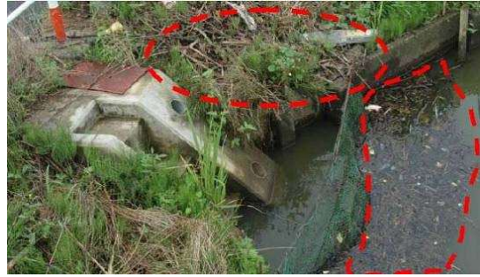
写真 38：取水部周辺の土砂やゴミの堆積
