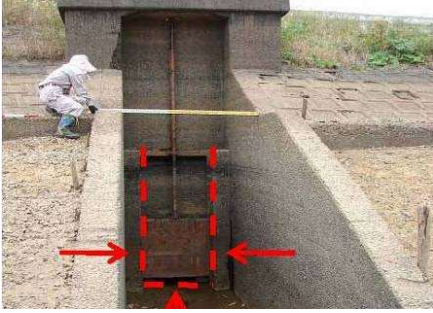
写真 37：ゲート周りの漏水
