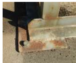
貯蔵タンクの固定
