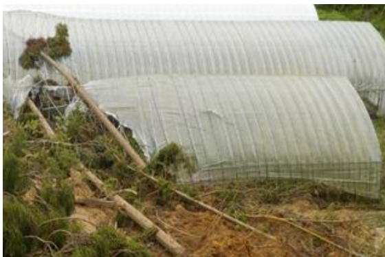
倒木・土砂流入によるハウス倒壊
