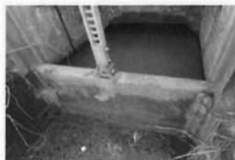
水路ゲートの劣化
