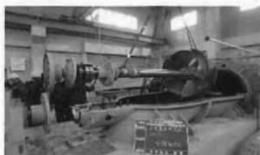
排水機場ポンプの破損
