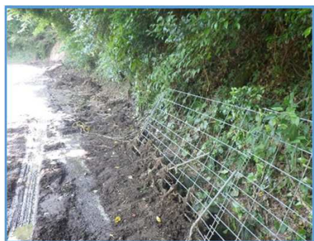
【被害時】防護柵が雨と土砂によって流されてしまいました。
